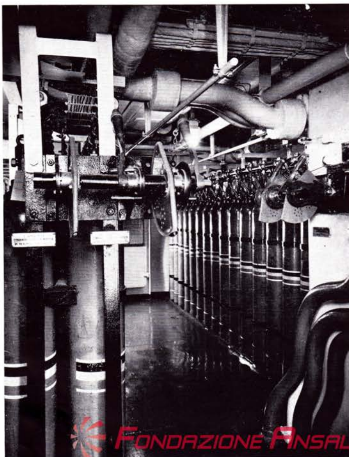
Ponte « A » - Stazione CO 2 - Meccanismi di collegamento e manovra bombole CO 2.
