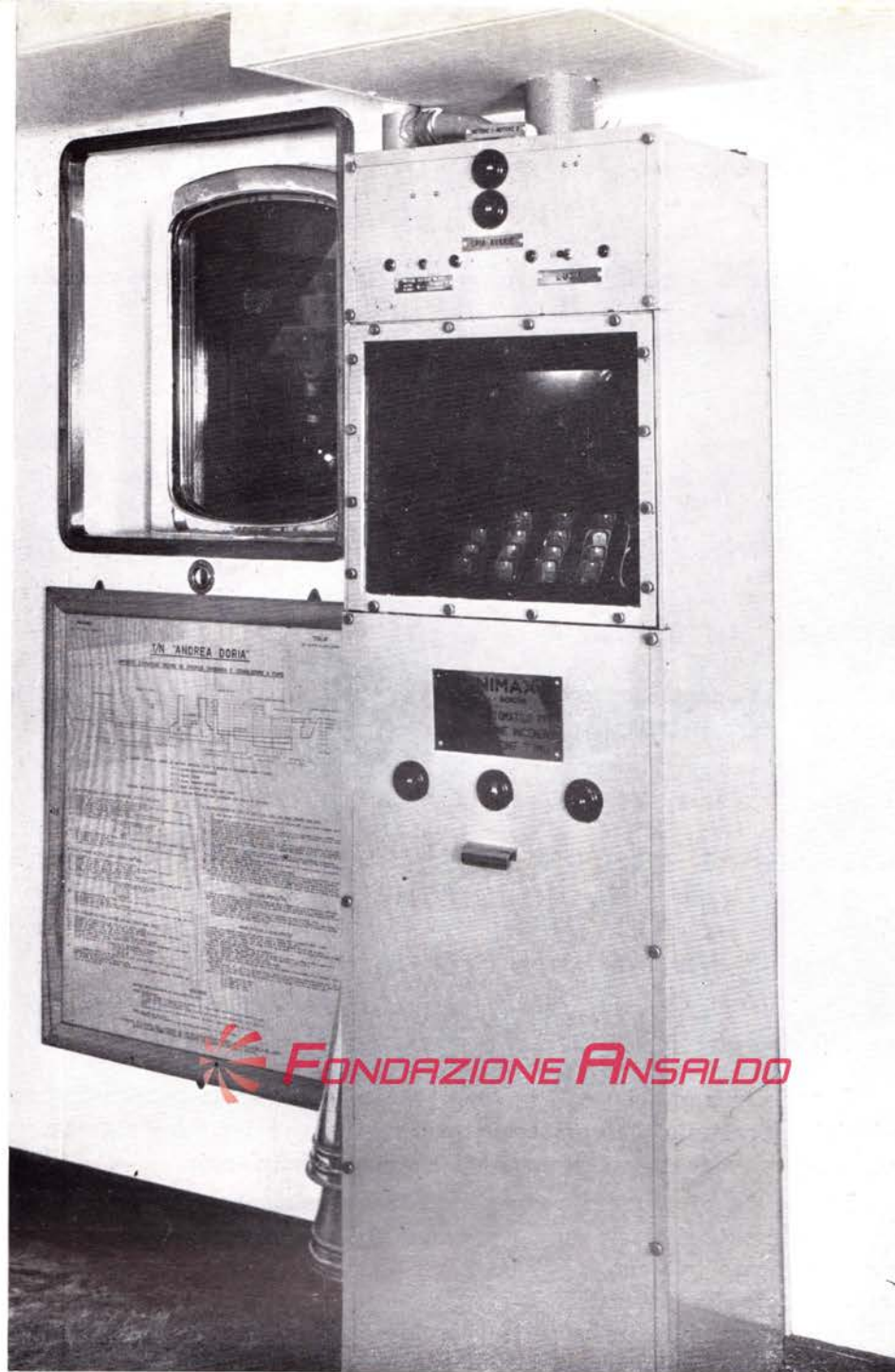
Ponte di Comando (timoneria) - Quadro principale impianto automatico per segnalazione incendio ad aspirazione di fumo
