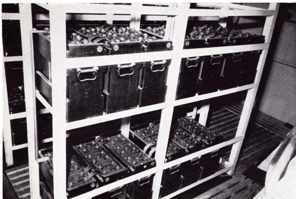
Fig. 29) Locale batteria accumulatori Nife di emergenza.
