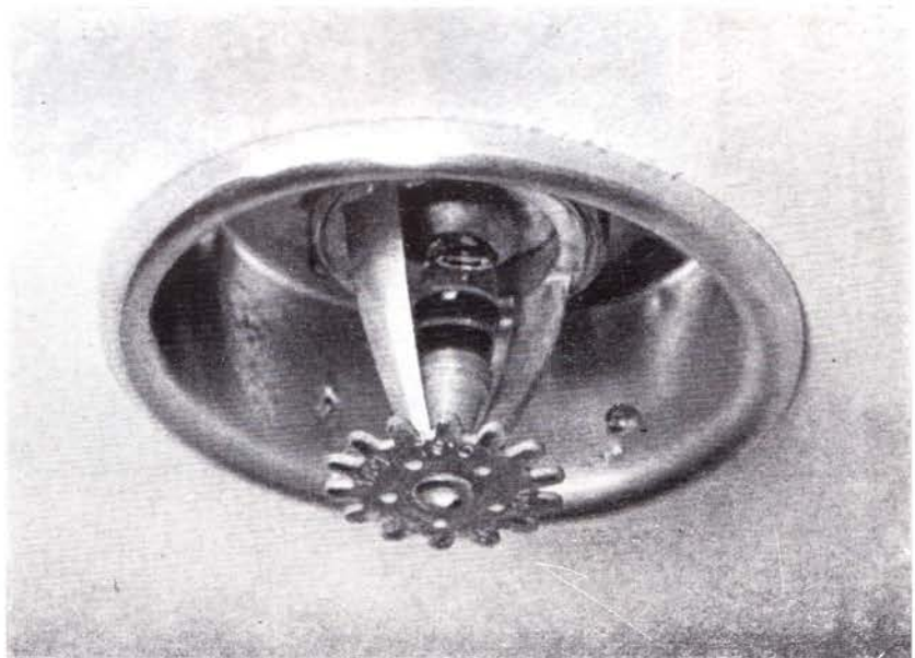
Particolare spruzzatori Sprinkler incassati a soffitto.
