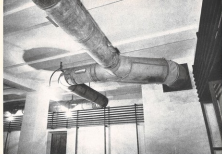
INTERNO di una cella del Cembalo a -20^{\circ}\text{C} con particolare del canale ad anello chiuso e radiatori a fascio. A destra: montaggio di un compressore frigorifero alla Termocomarion.
